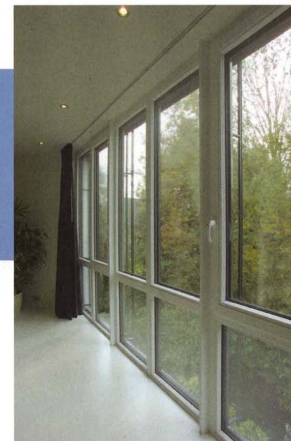
Op de zuidkant van het huis zijn de grote raampartijen aangebracht, met ingebouwde zonwering aan de buitenzijde.
