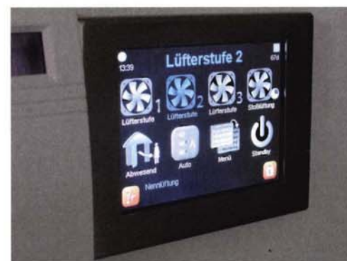
Essentieel bij een passiefhuis is de ventilatie: deze kan door middel van dit scherm worden ingesteld.
