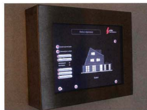
Via het domotica-systeem kan de complete elektrische installatie in huis worden gecontroleerd en geregeld.
